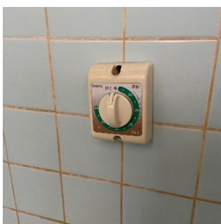
循環釜リモコン
