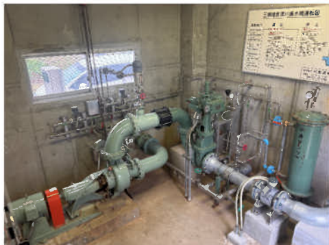
三郷堰第三揚水機場ポンプ設備全景
