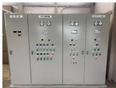
電気設備・機側操作盤
