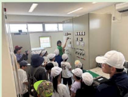
中山揚水機場管理棟で操作を学ぶ
