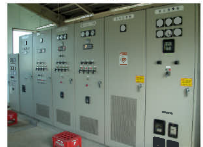
三郷堰第一揚水機場電気設備
