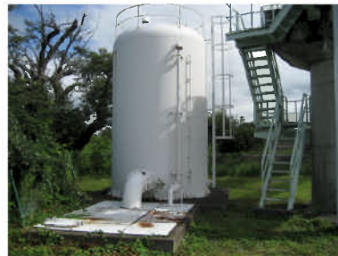
三郷堰管水路附帯設備サージタンク
