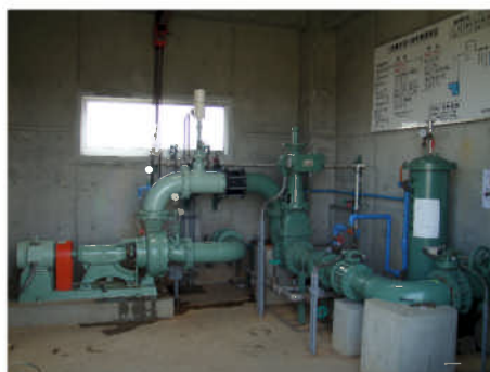
三郷堰第三揚水機場ポンプ設備
