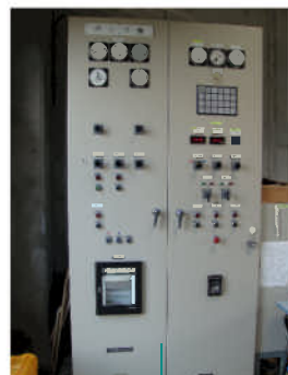
電気設備・機側操作盤
