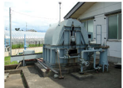
三郷堰第一揚水機場除塵設備
