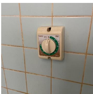
循環釜リモコン
