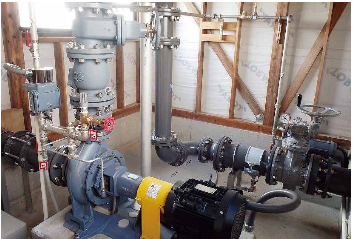
【写真：河原田揚水機場】
