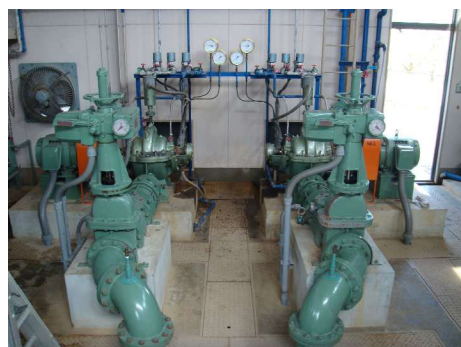
三郷堰第二揚水機場ポンプ設備
