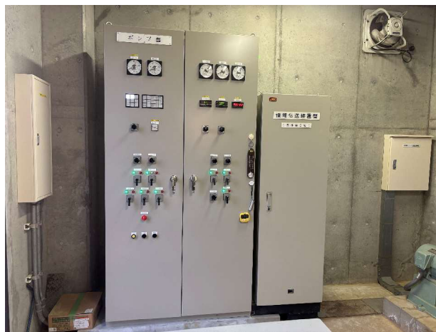
電気設備・機側操作盤
