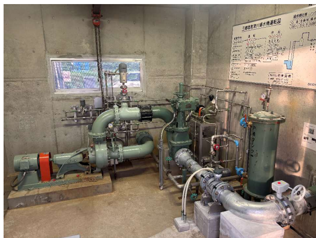
電磁流量計・補機設備
