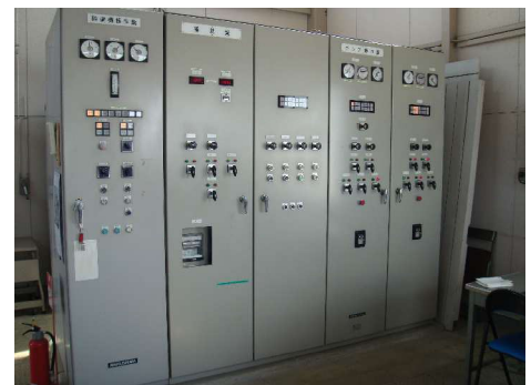
電気設備・機側操作盤
