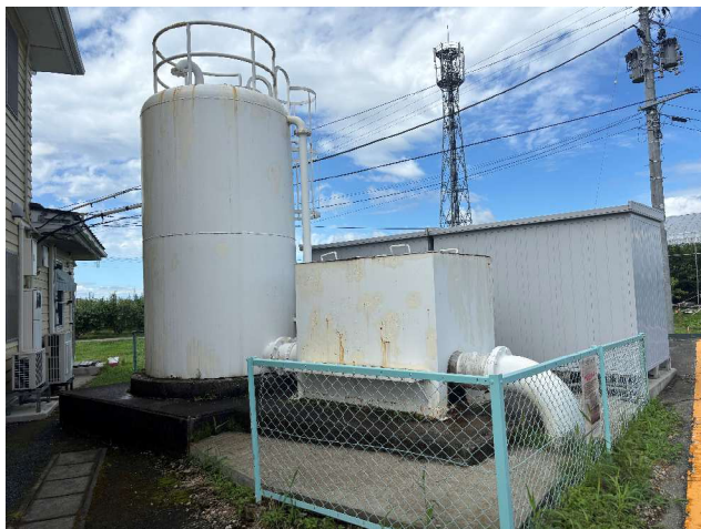
三郷堰幹線送水管附帯設備サージタンク
