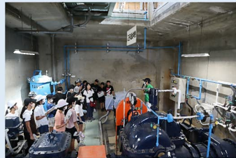
【高揃小】揚水機について学習
