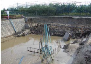
水害再び吸水槽ブロック崩壊
