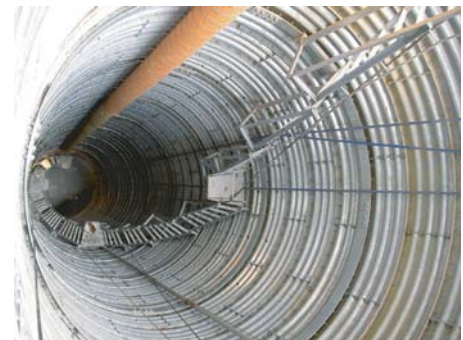
地下水を集める集水井（しゅうすいせい）のようす
