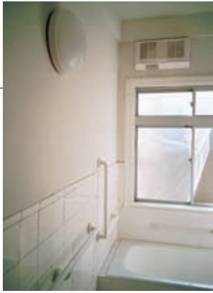
浴室の換気暖房乾燥機
