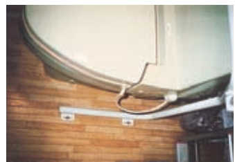
床に固定したトイレの手すり
