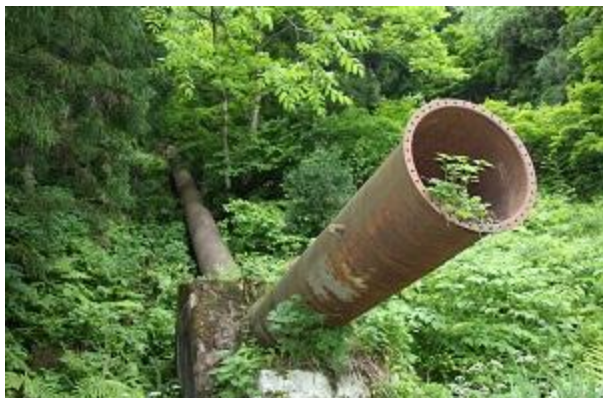
小野川水力発電所が閉鎖されて40年以上 が経過し、山林にひっそりと残る送水管
