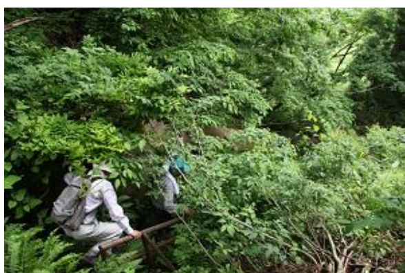
草木が生い茂る中、木々の隙間から 赤茶けた姿をのぞかせる送水管
